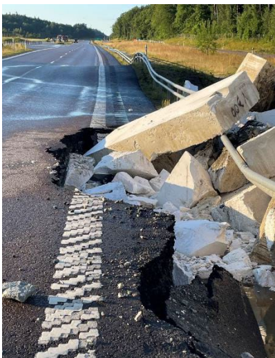
Extremt stora vattenmassor skapade underminerade vägbanor. Foto: RSG
